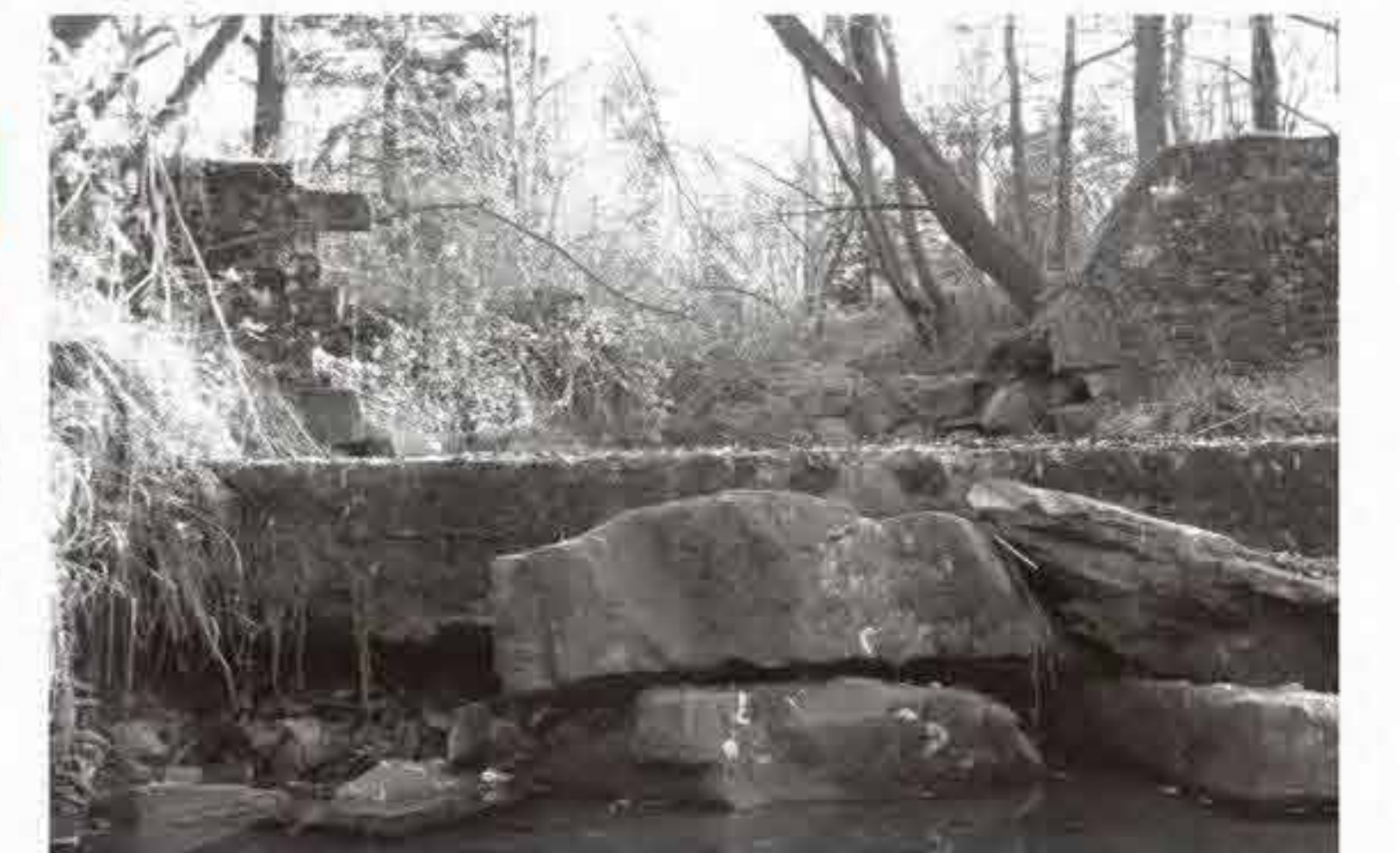
Jeden z uszkodzonych stopni na Sudole
